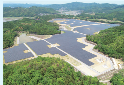
ソーラー市島発電所
