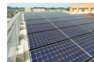
屋上太陽光発電設置事例
