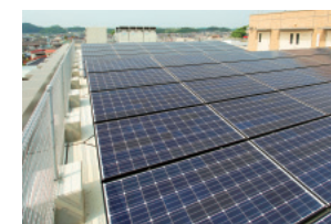
屋上太陽光発電設置事例
