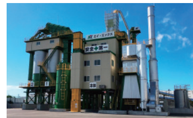
新潟合材工場： ・プラントを全閉型のシェルタータイプ、都市ガスを燃料としている。 ・破砕機的能力を増加させ、より一層廃材の受入れを強化し、再資源化を図る。
