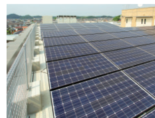
屋上太陽光発電設置事例
