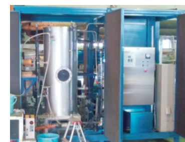
MBO促進酸化処理装置
