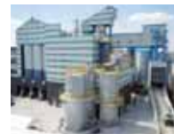
横浜北合材工場：プラントを全閉型のシェルタータイプ、都市ガスを燃料とし、かつ脱臭炉を導入。
