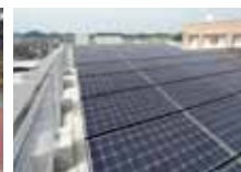
屋上太陽光発電設置事例
