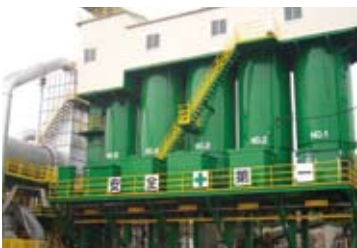
合材サイロを全閉型のシェルタータイプとし、環境整備を図った大和合材工場
