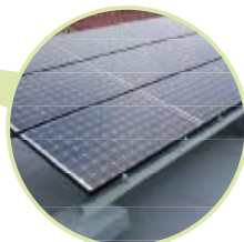
屋上太陽光発電システム
