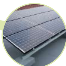
屋上太陽光発電システム
