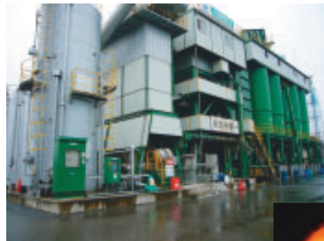
アスファルト合材工場
