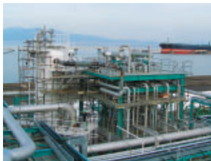
喜入基地 TVR設備
