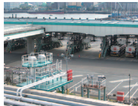
根岸製油所 ETBE調出荷設備
