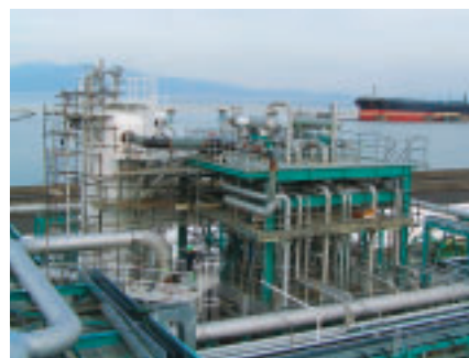
喜入基地 TVR設備
