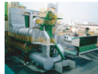
リサイクル合材製造装置（横浜合材工場）
