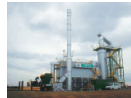
加熱乾燥プラント2号機
