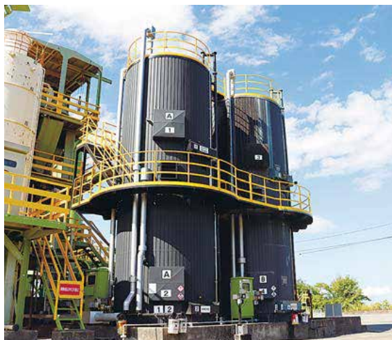
生まれ変わったアスファルトタンク
