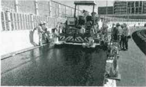
スマートグースを使った施工の状況。一般的なグリースアスファルトと同様に施工できる
