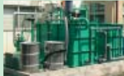
揚水曝気装置
