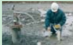
酸化剤注入井戸とモニタリング状況
